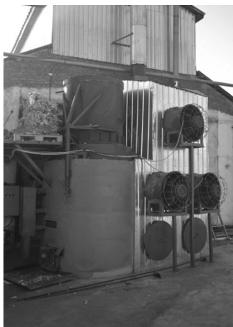
Фото 2. Газогенераторна піч на відходах с. г виробництва. Потужністю 1,5 МВт обладнана для сушки зерна.
